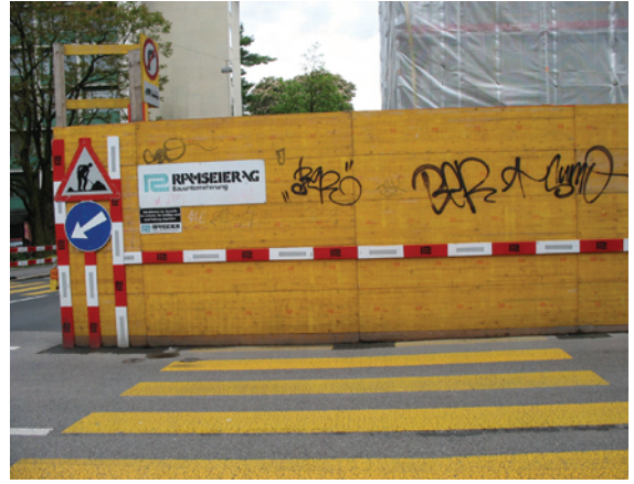
Améliorable : le passage piéton se termine sur une impasse. Il devrait être temporairement couvert et remplacé. La suppression doit aussi être reconnaissable par les personnes malvoyantes.
