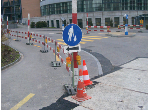
Améliorable : le passage piéton est barré. Aucune solution de remplacement n'est prévue.
